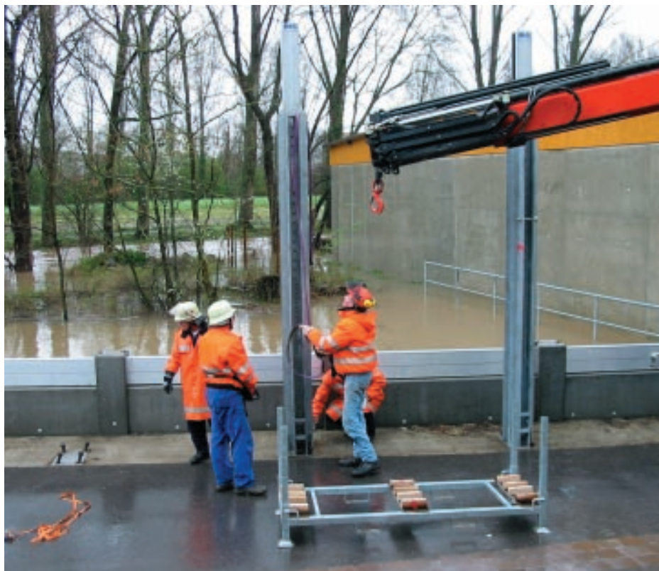
Hochwassereinsatz in Bad Friedrichshall
