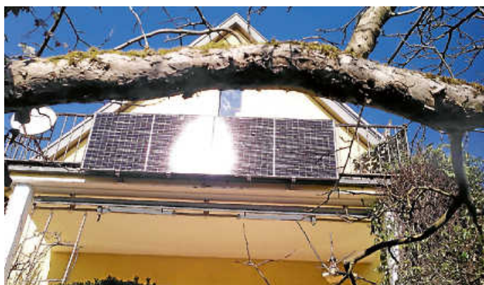
Beispiel eines Balkonkraftwerks
